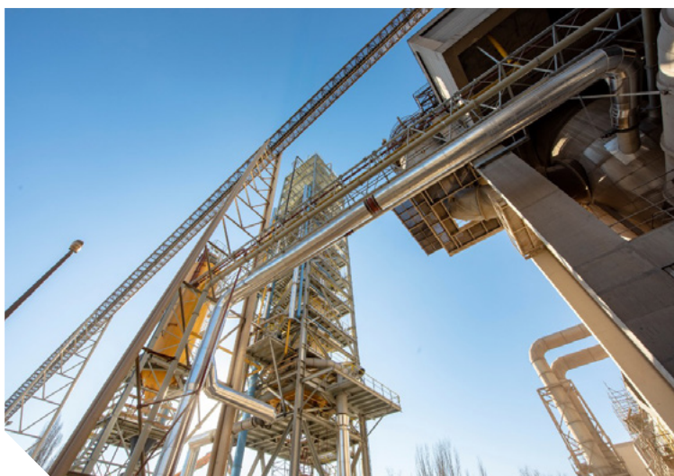
Carbon Capture installatie van een klinkerproducent.
